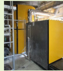
給湯・暖房用ボイラー130kW
