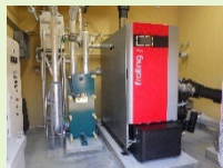
暖房用ボイラー150kW
