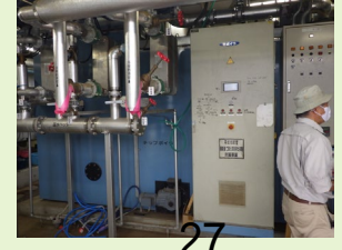
暖房用ボイラー200kW
