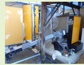
給湯・暖房用ボイラー50kW
