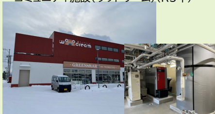
暖房用ボイラー180kW
